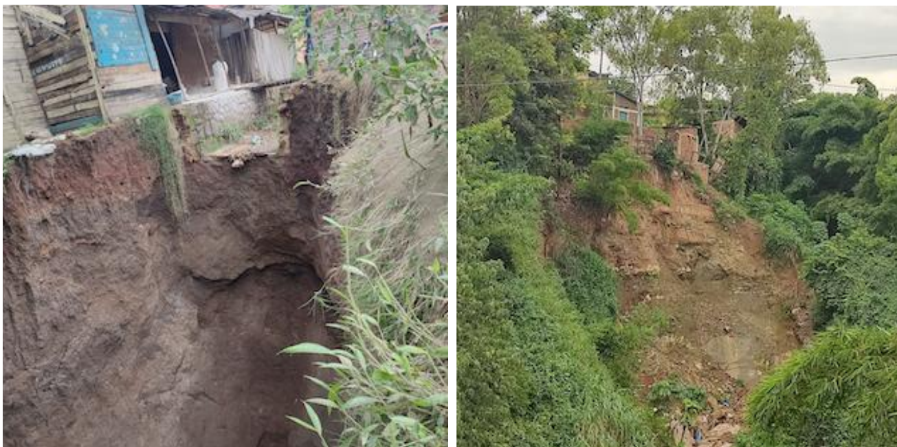
Photo 7 - Ravinement à partir d'un canal d'évacuation et glissement des berges sur Gasenyi (Rweza)
