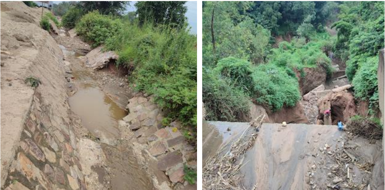
Photo 6 - Destruction du canal de Gasenyi (Rweza) et son ravinement en aval
