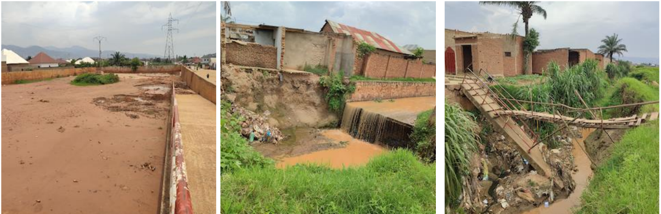
Photo 11 - Bassin de décantation et destruction de maisons et du ponceau à Buhinyuza (Kinama)
