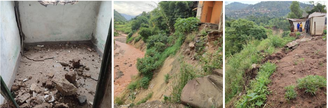
Photo 8 - Maison détruite par fissure (Bisekuro) et 2 autres par glissement des berges (Ntahangwa)
